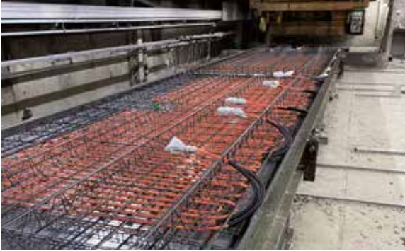
Die Rohrregister sind in den LTKH-Klimadecken oberflächennah positioniert.
