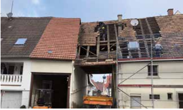
Der Altbau war mit seinen morschen Balken und maroden Mauern nicht mehr zu halten.
