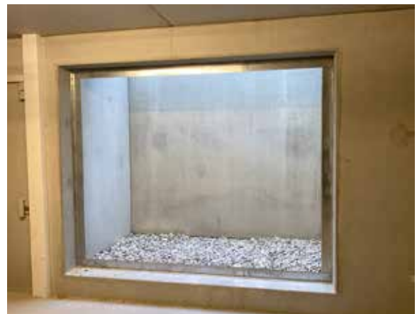
Revisionschacht für die Hackschnitzelanlage aus Betonvollelementen.
