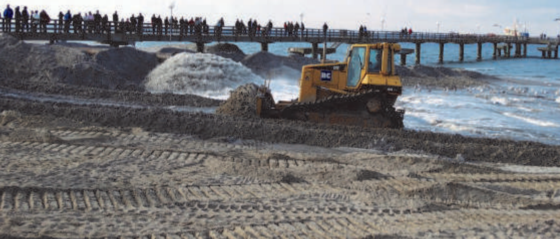
Abbildung 5: Marine Sandlagerstätten werden wie hier bei Rerik (Landkreis Rostock) vorrangig für Strandaufspülungen zum Küstenschutz genutzt (Foto: A. Börner, 2001).
