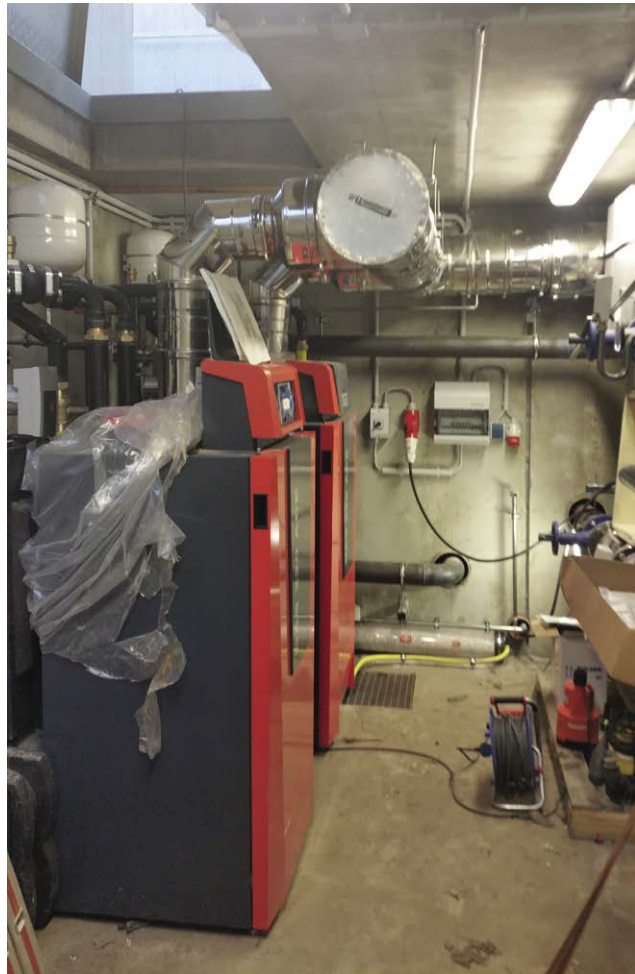
Abb. 13.7: Technische Anlagen arbeiten Tag und Nacht – allerdings nicht geräuschlos. Die Raumzelle für die Technische Gebäudeausrüstung ist aber weit genug entfernt vom sensiblen Wohnbereich.
